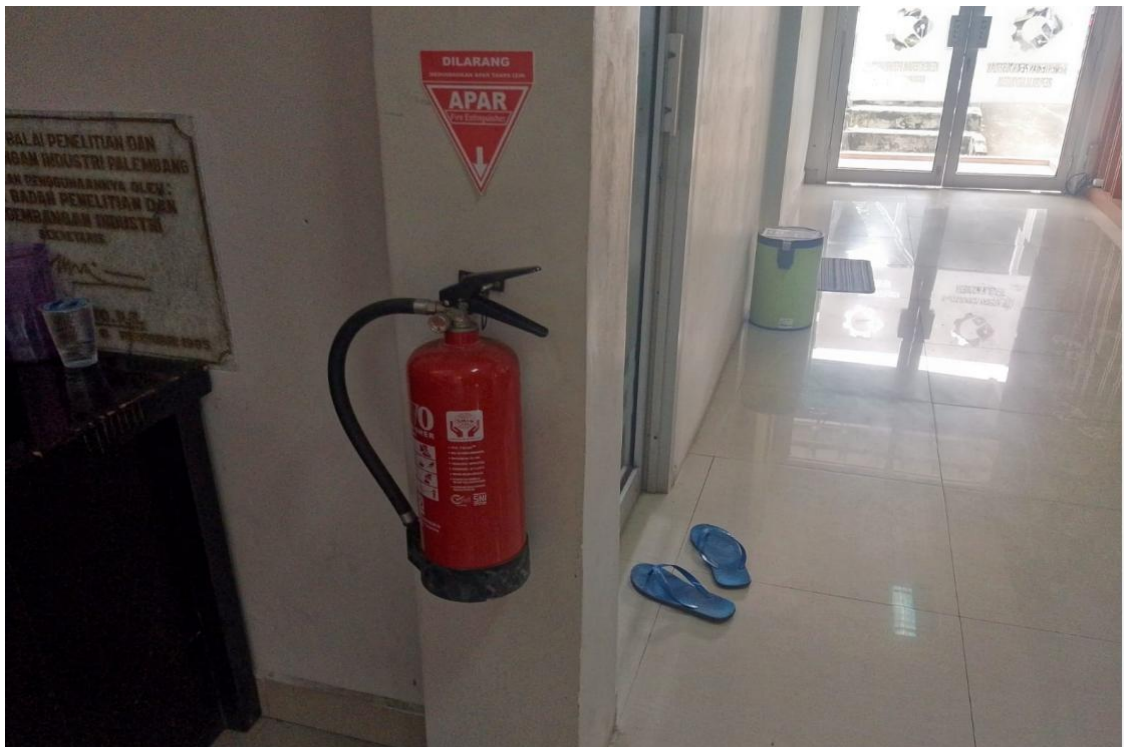
Gambar 18. Apar pengendalian kebakaran
